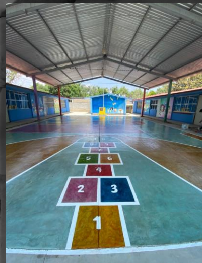
SOBRE PISO OXIDADO
