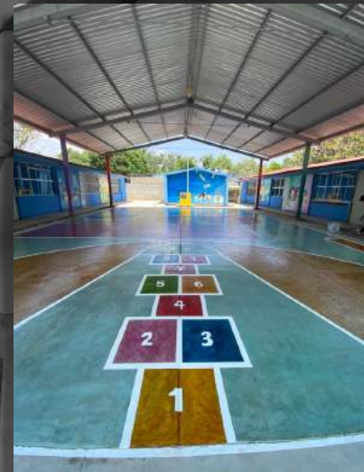
SOBRE PISO OXIDADO
