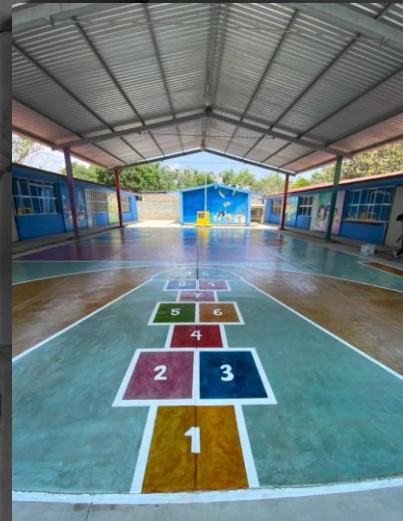
SOBRE PISO OXIDADO
